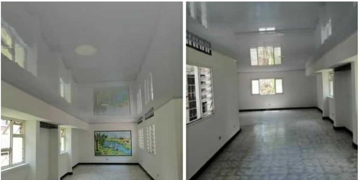
Mejoramiento de Cielo razos en pvc sede central
